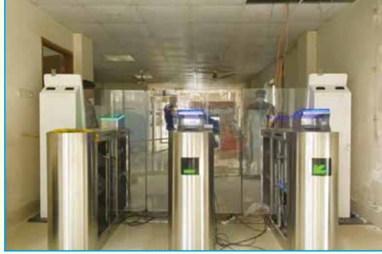
সচিবালয়ের প্রবেশমুখে ডিজিটাল অ্যাক্সেস কন্ট্রোল সিস্টেম স্থাপন
